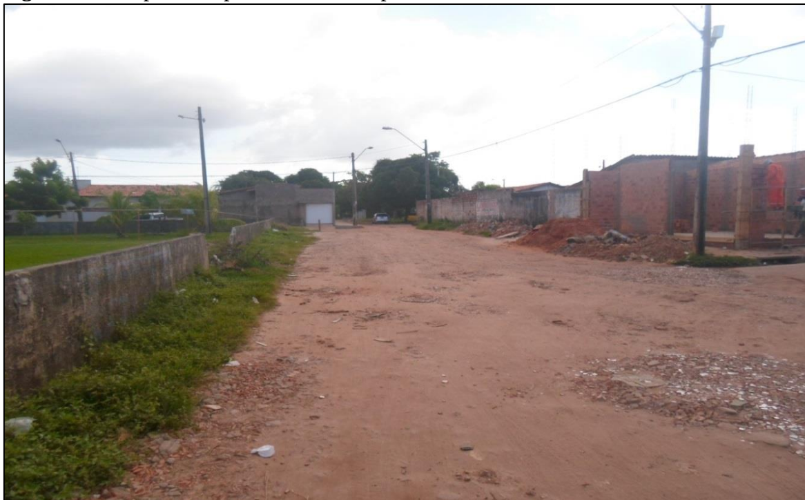
Figura 60: Via pública apresentando total perda da cobertura de asfalto.
