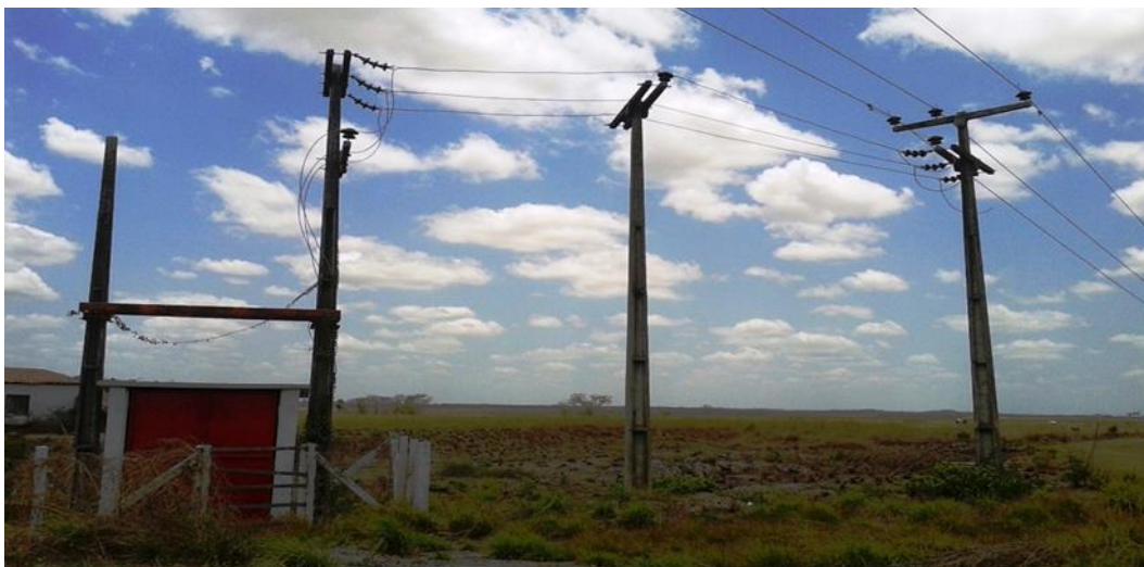
Figura 5 - Rede elétrica do projeto Salangô.
