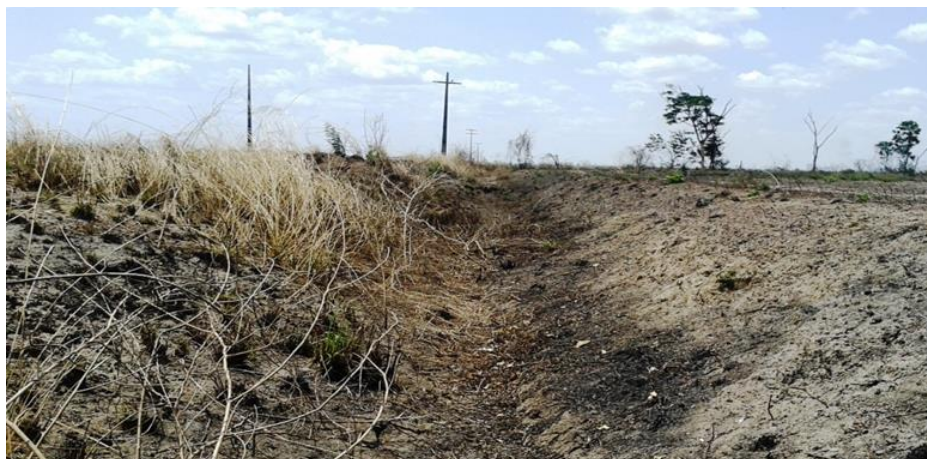
Figura 26 - Rede de drenagem as margens da via de acesso ao projeto de irrigação Salangô
