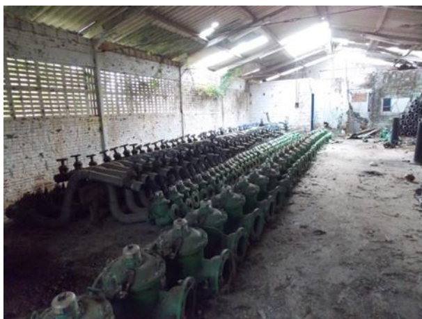
Figura 8 - Bombas de irrigação por aspersão.
