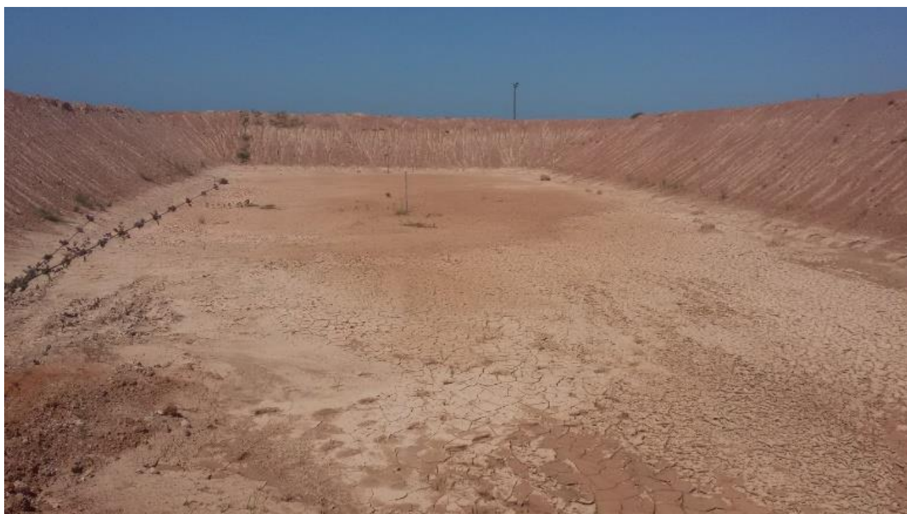
Figura 28: Solo permeável da cova em desacordo com o projeto
