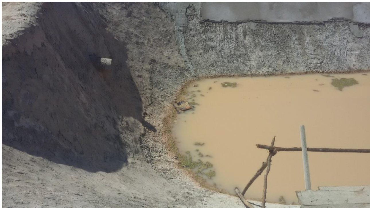
Figura 31: Impermeabilização feita na lagoa de decantação em desacordo com o projeto original
