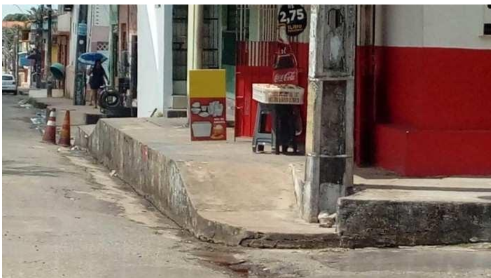
Foto 10 - Bairro Cohatrac. Rampa sem acesso acessível
