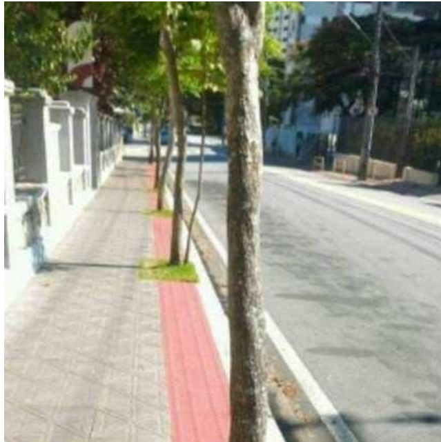
Foto 11 - Colocação equivocada de piso direcional
