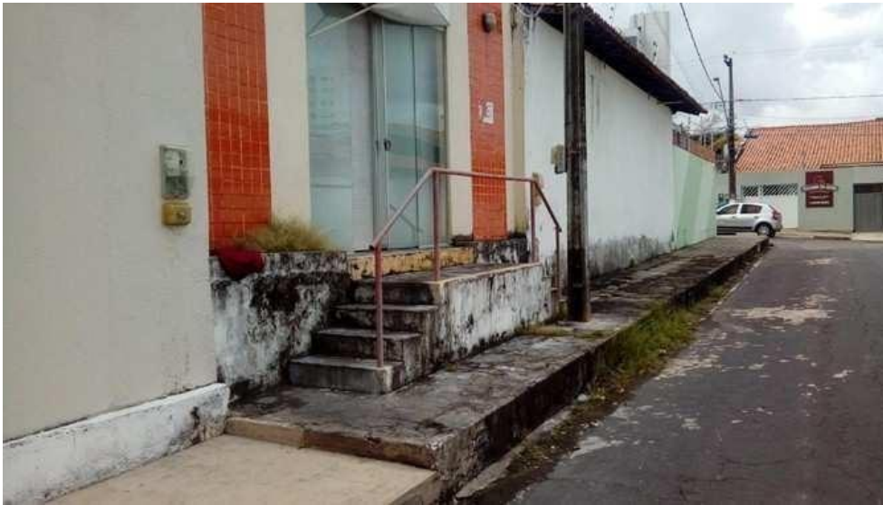
Foto 9 - Bairro Ponta d'Areia. Falta de rampa
