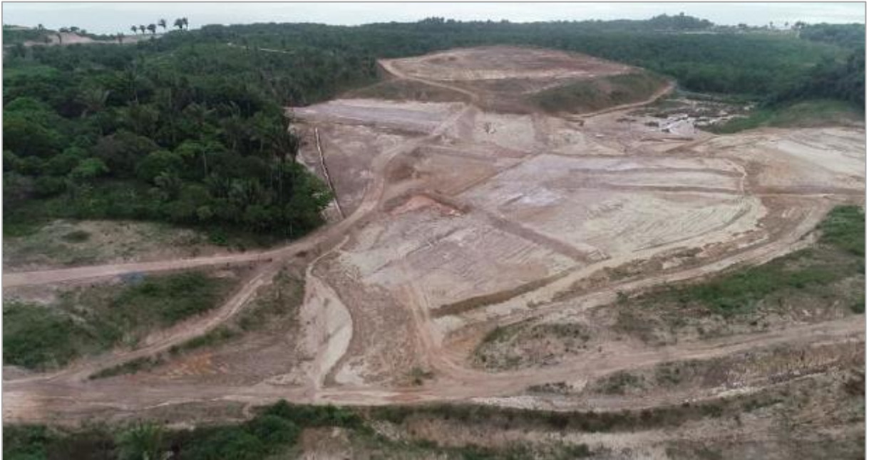
Figura 6 – Cajueiro, São Luís-MA: área desmatada em Parnauaçú por obras do TUP Porto São Luís
