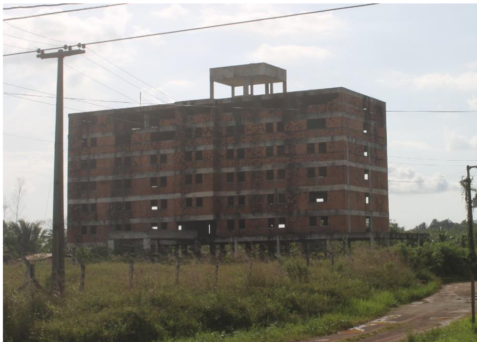
Figura 05: Construção abandonada do hotel em Santa Quitéria após anúncio do cancelamento da ida da Refinaria Premium I Fonte: ATHUAR, 2018
