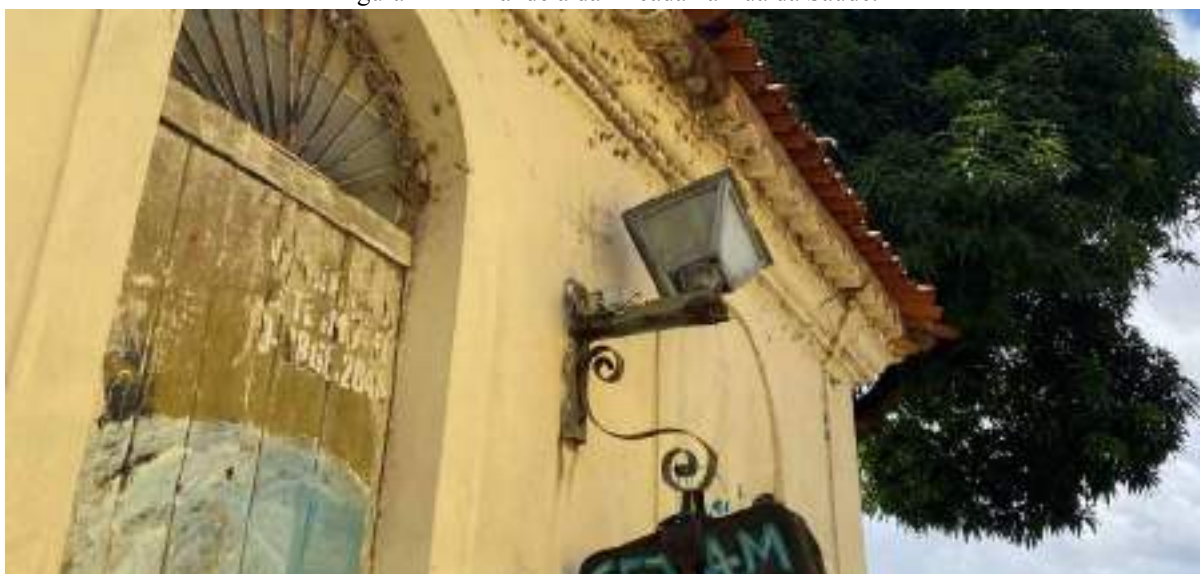
Figura 41 – Arandela danificada na Rua da Saúde.
